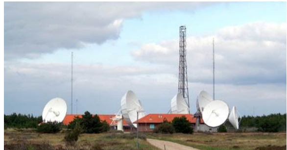
Blåvand Radio og antenneanlæg, syd for lokalplanområdet.
